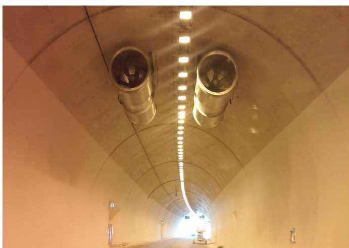
Σήραγγα Ακράτας 13Α – Σύστημα εξαερισμού
