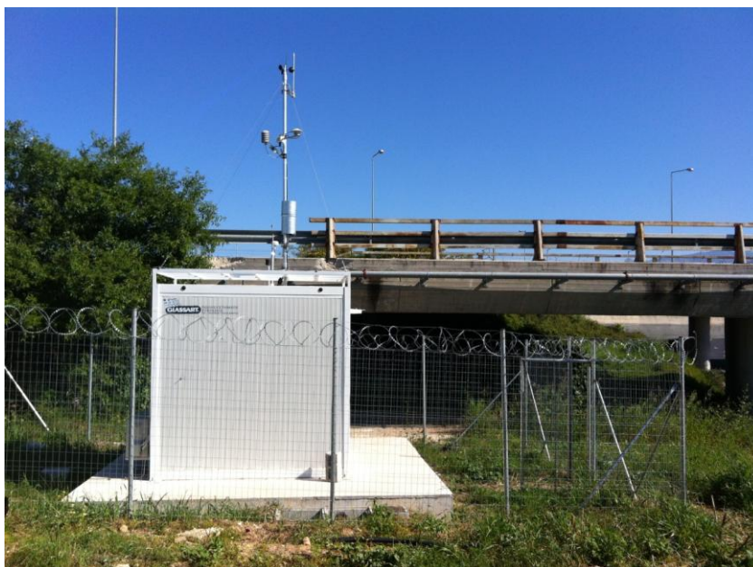
Σταθμός Η/Κ Τριπόλεως
