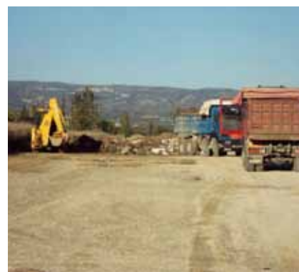
Αποκομιδή ανεξέλεγκτων αποθέσεων απορριμμάτων χ.θ. 95+100
