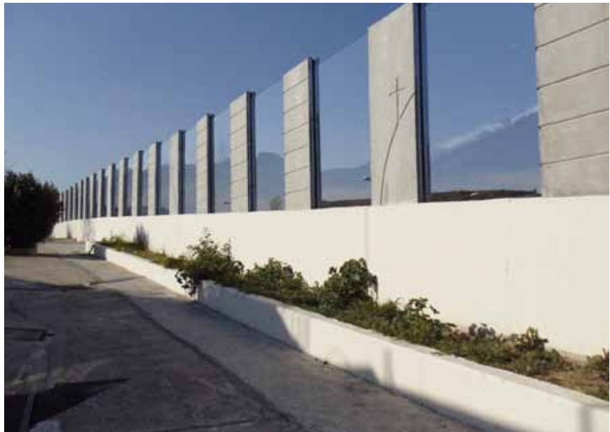
Εγκατάσταση αντιθορυβικών πετασμάτων, στα υφιστάμενα τμήματα του Έργου (l. Μονή Ζωοδόχου Πηγής, Ευρεία Παράκαμψη Πάτρας)
