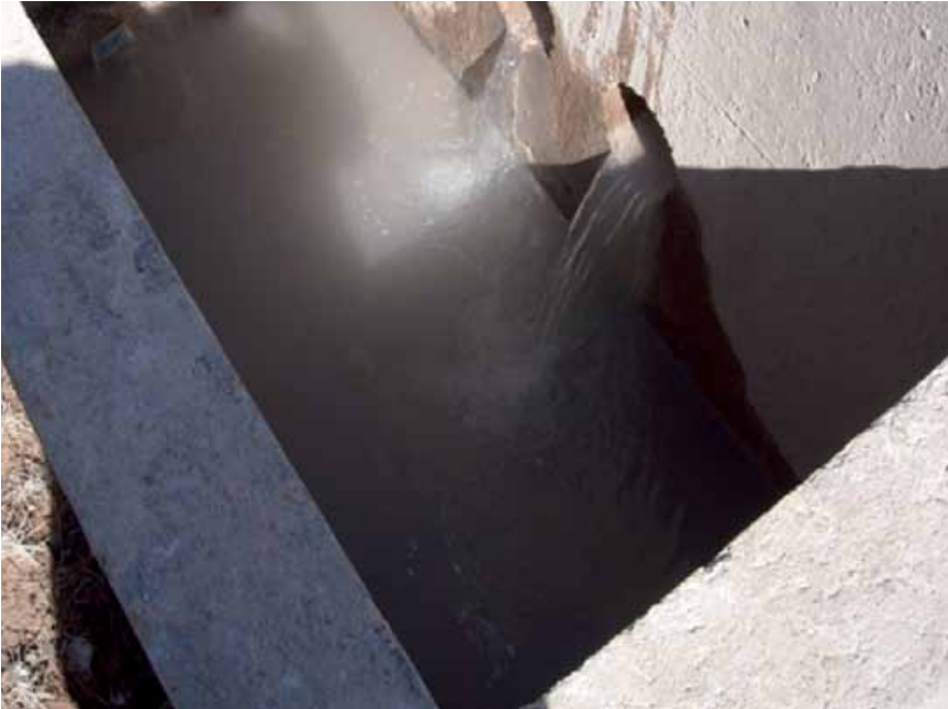
Δεξαμενή καθίζησης στην σήραγγα Παναγοπούλας
